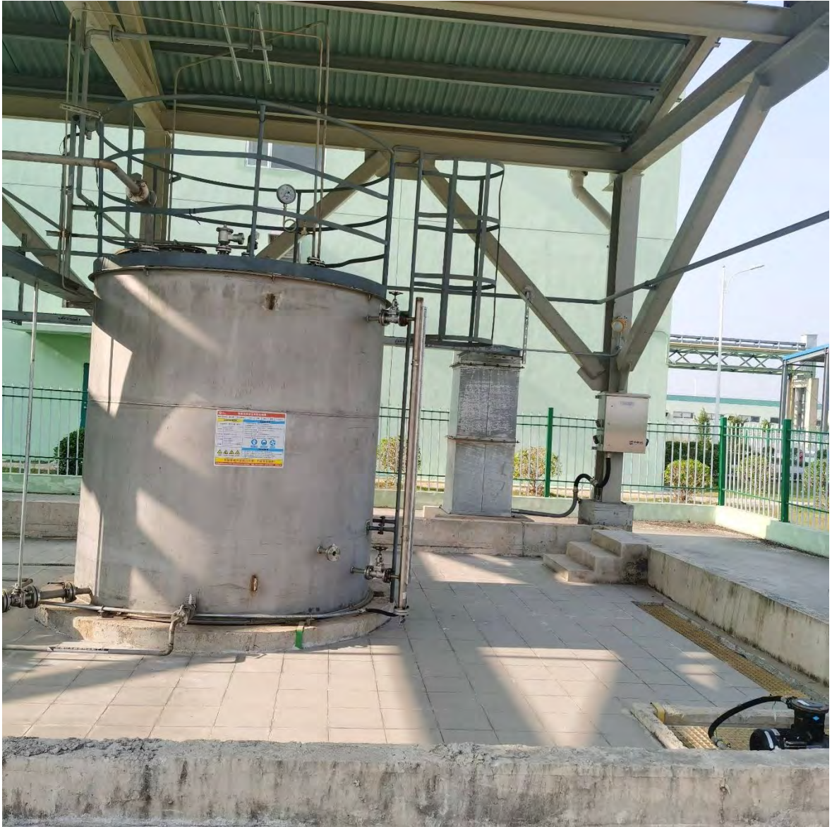
图 9.5-5 燃气热电一期锅炉配设的氨水储存罐及其围堰
