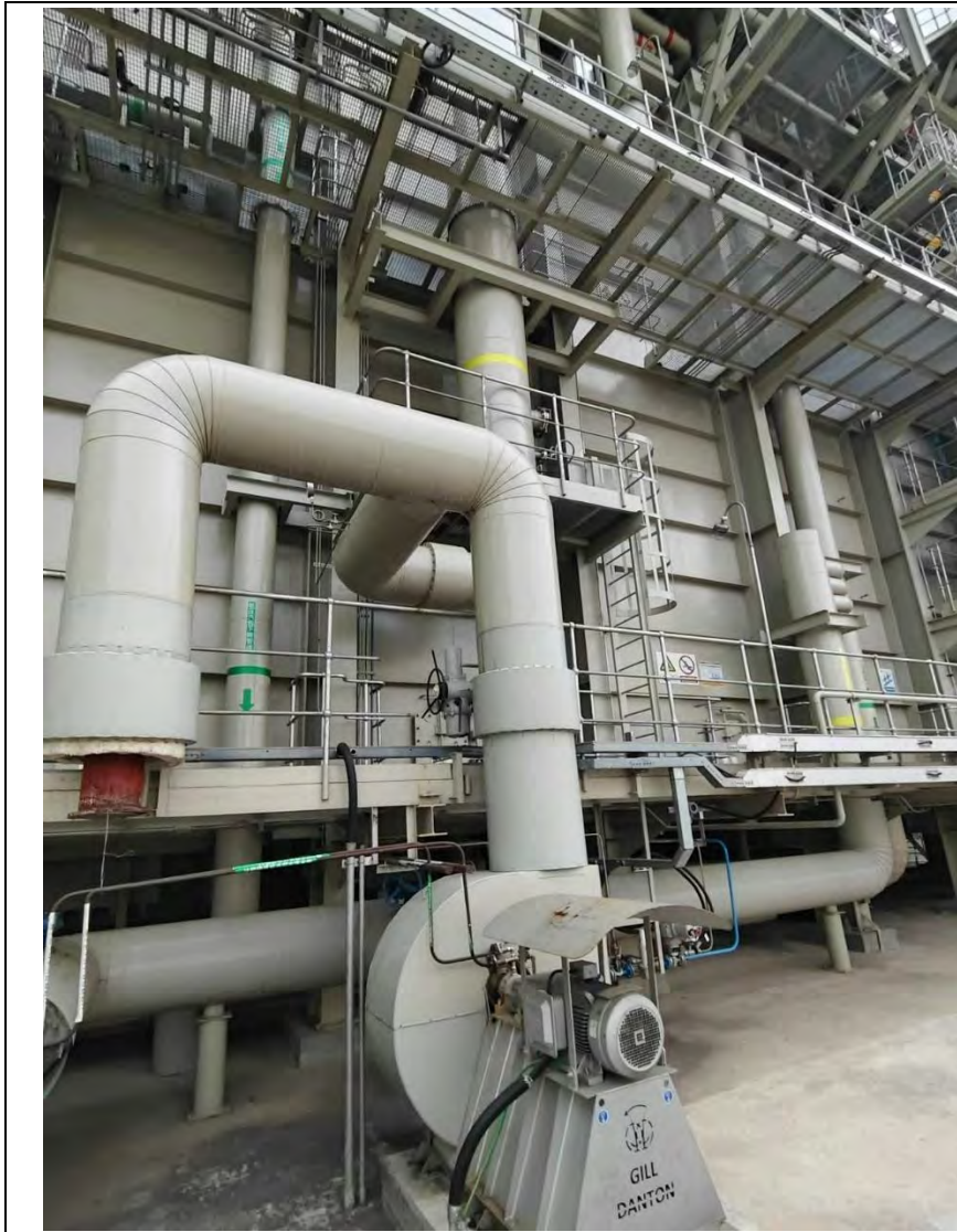
治理设施照片- SCR 脱硝装置
