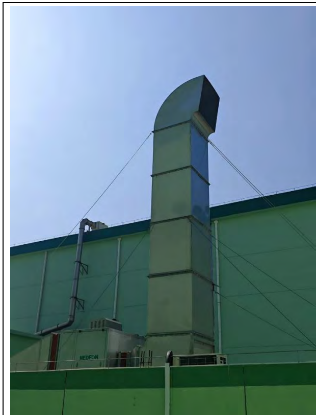
厨房油烟装置
