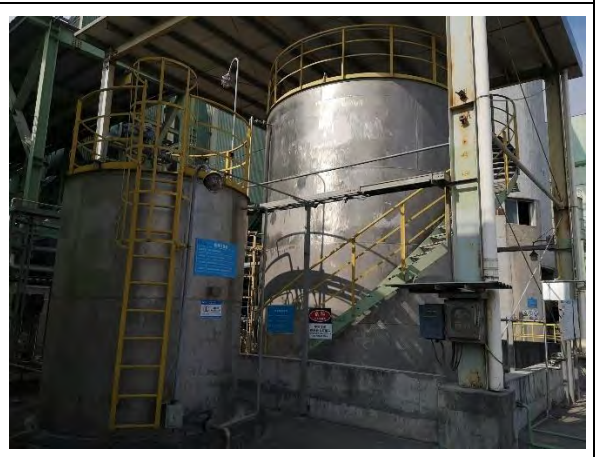
SNCR 脱硝系统
