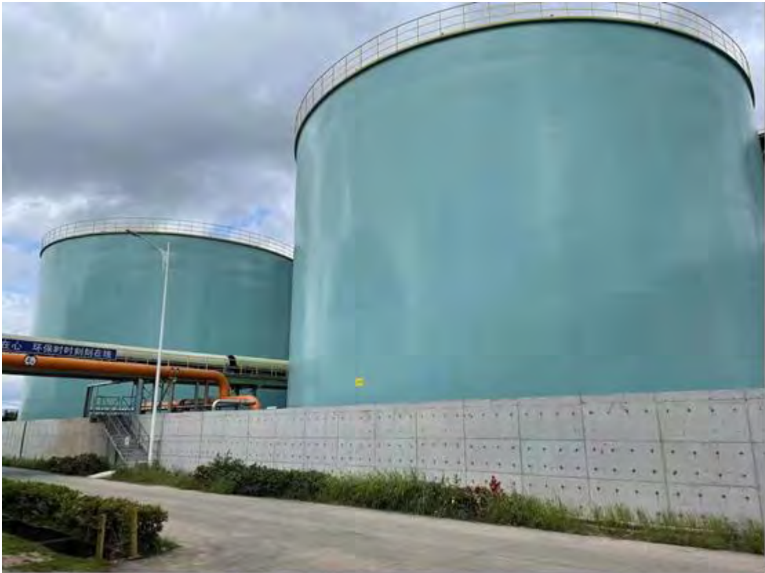
图 9.5-3 厂区污水站区域应急罐
