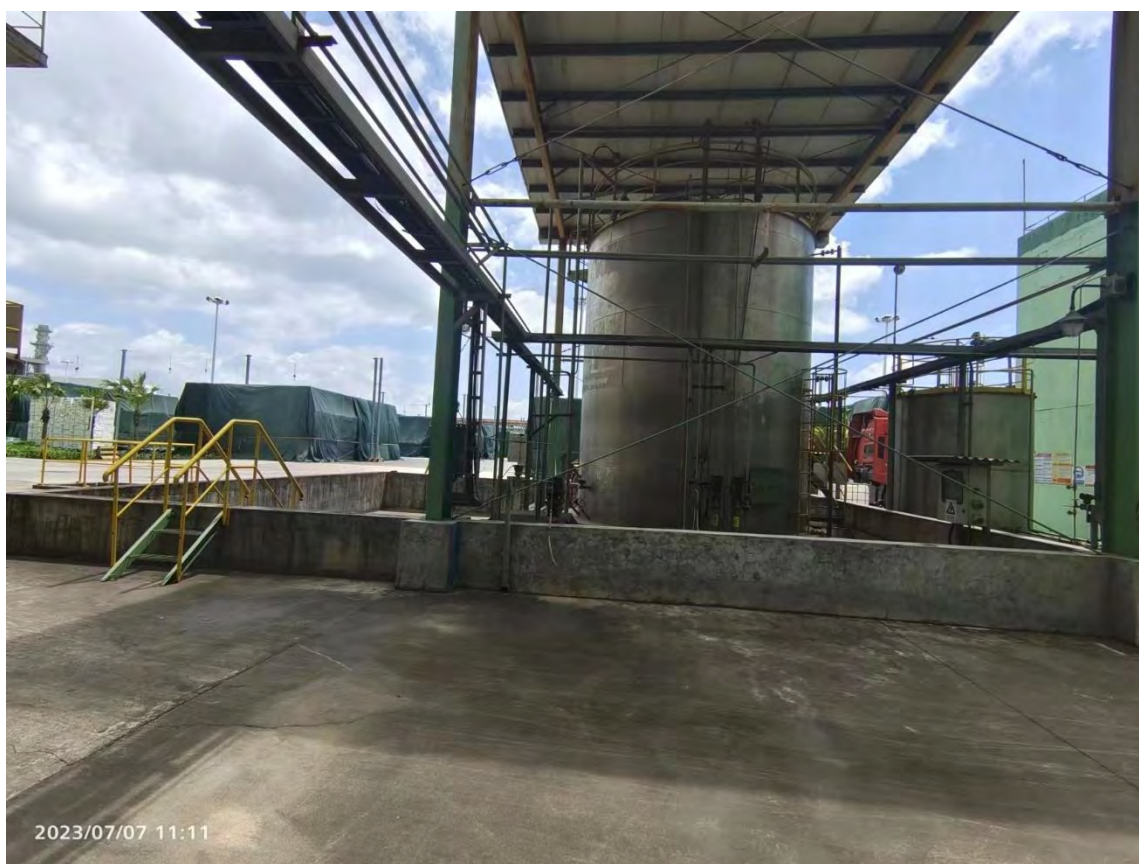
图 9.5-2 现有锅炉配设的氨水储存罐及其围堰
