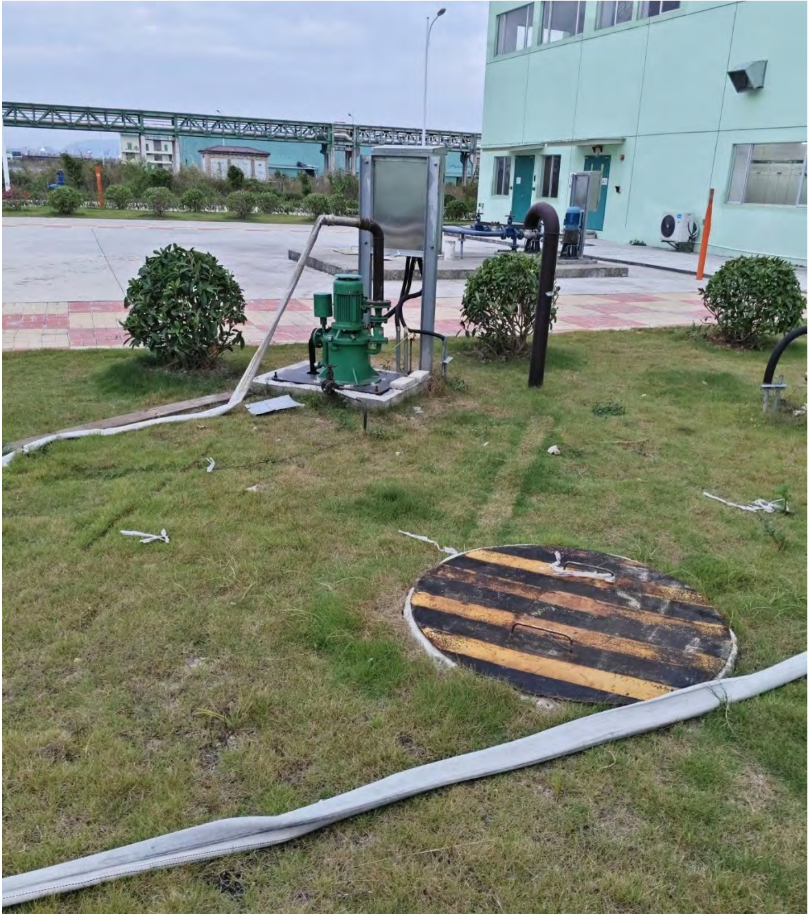
图 9.5-6 燃气热电一期配设的汽机事故油池和燃机事故油池
